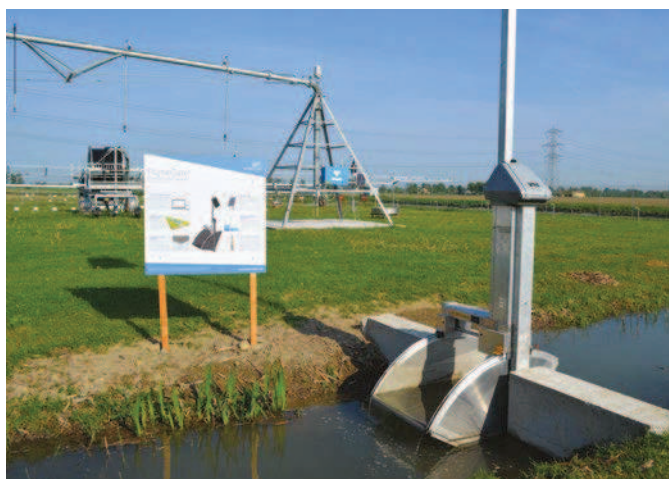
Flume Gate, paratia per controlli automatici nella distribuzione dell'acqua.
